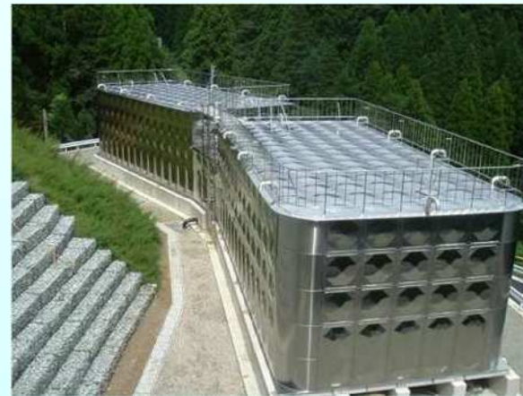
パネル形配水池
