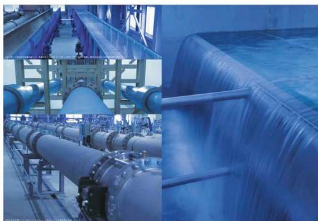
実流量校正設備 Calibration flow facility
