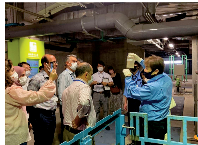
入江崎水処理センター(2022)
