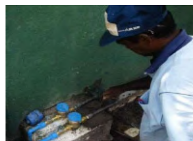
スリランカに設置されたメーター Water meter which is installed in Sri Lanka
