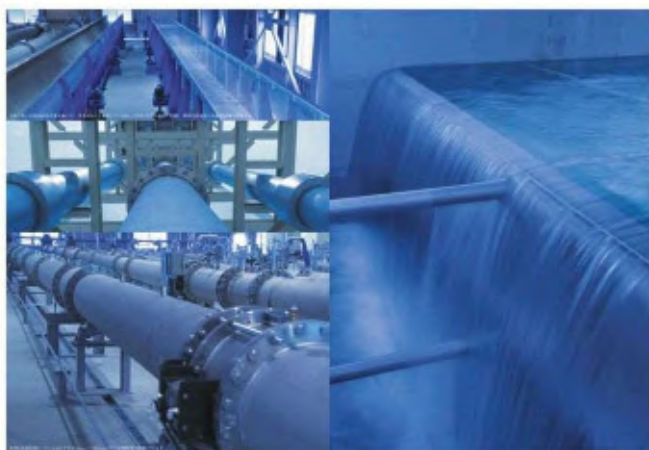
実流量校正設備 Calibration flow facility
