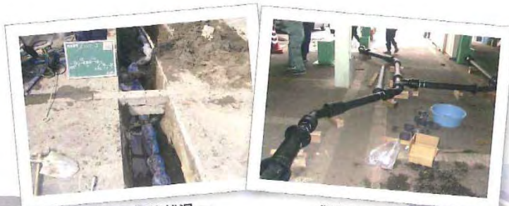
現場配管状況
