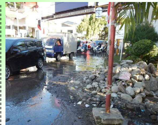
マカッサル市漏水現場
