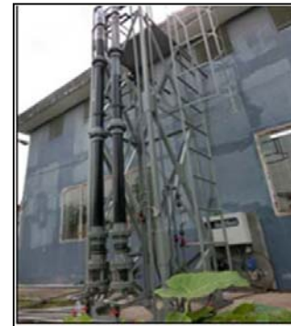
実験プラント外観
