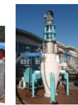
K3システム 浄水場ろ過池 維持管理システム
