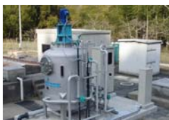
(自治体) 日立市水道局中里浄水場 1500φ 飲料水供給
