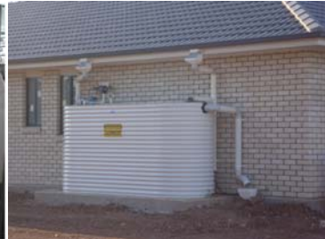
住宅に設置された雨水タンク
